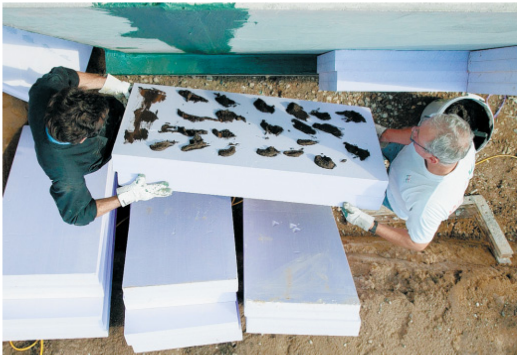
Fachgerechte Installation: Geprüfte Materialien und der Einbau durch Handwerker sichern Bauherren vor Brandgefahr.
